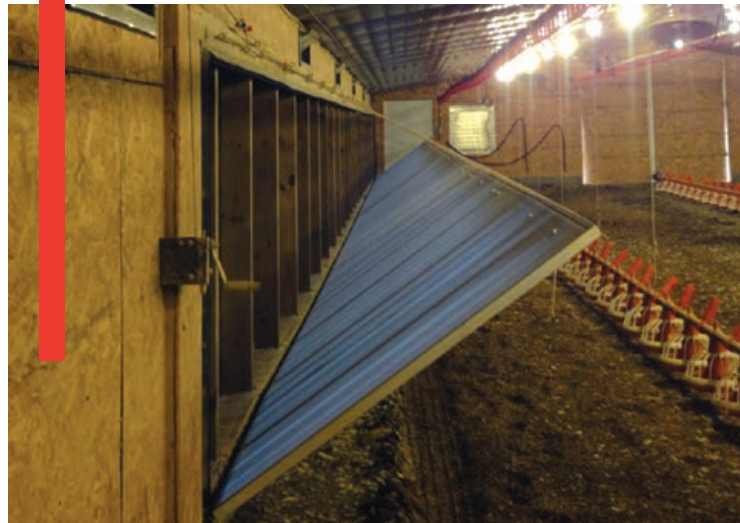
FIGURA 1. Compuerta de entrada de aire en un sistema de ventilación túnel.
