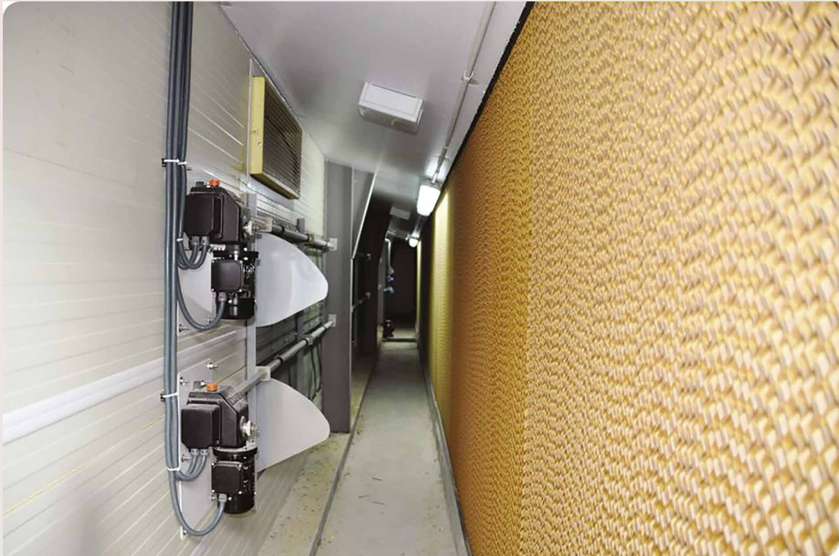
Interior del túnel de refrigeración, con los paneles de celulosa y la doble trampilla mecanizada para la entrada del aire frío en la nave.
