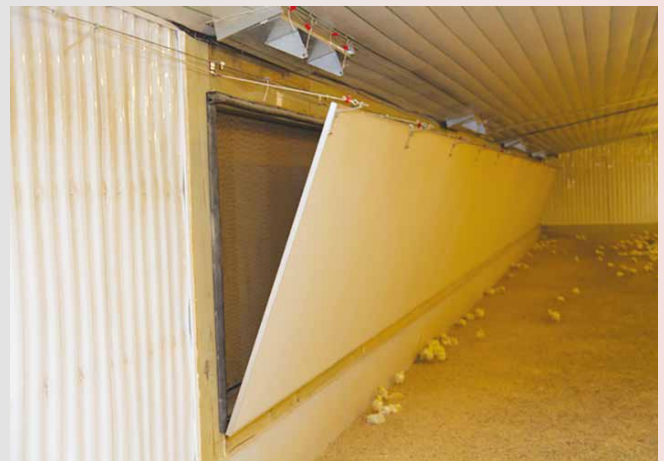
Compuerta de entrada de aire para una ventilación túnel
