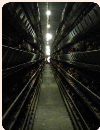
LED instalados en esta nave, colocados demasiado direccionales, muy separados y no suficientemente brillantes, dando sombras en el piso y una mala uniformidad de luz en las jaulas.
