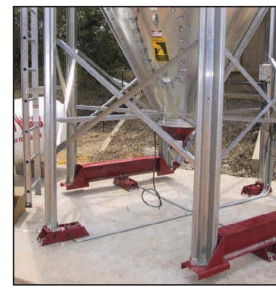
Silos con células de carga
