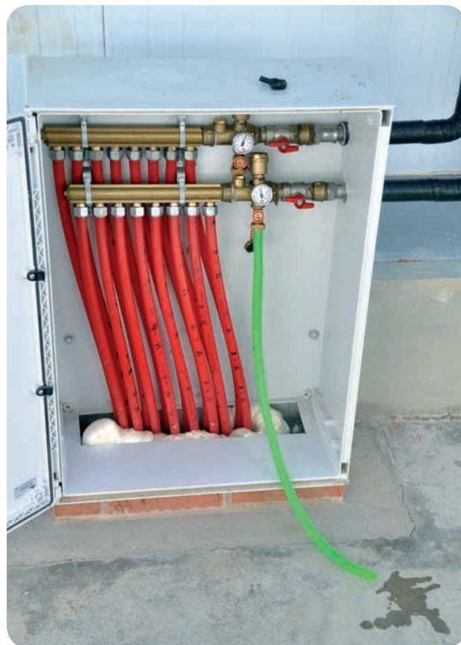
Una de las cajas de entradas de los tubos de agua caliente, en el pasillo central.
