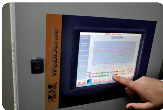
El ordenador de control ambiental.
