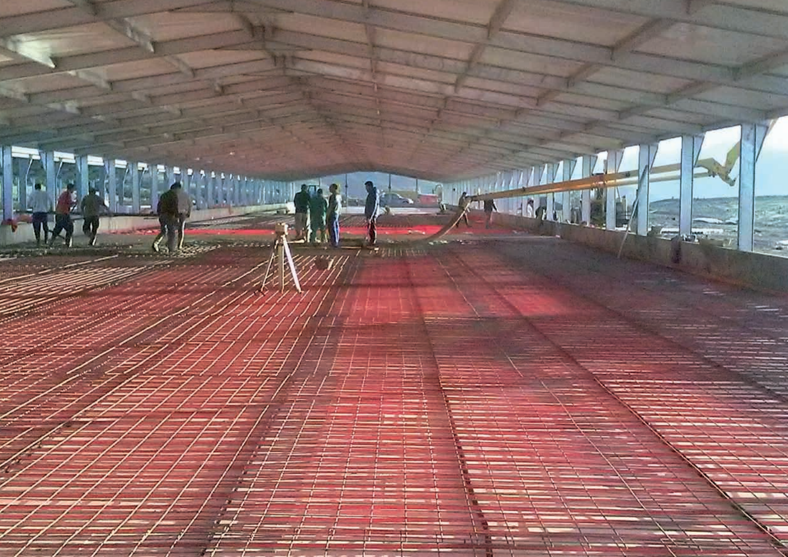
Extensión de los tubos de agua para la calefacción mediante suelo radiante, durante la construcción.
