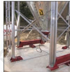
Silos con células de carga
