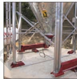
Silos con células de carga
