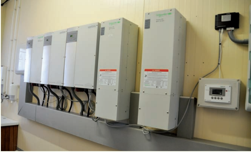
Los reguladores y los inversores eléctricos montados por la empresa Ekain Tadea, S.L.
