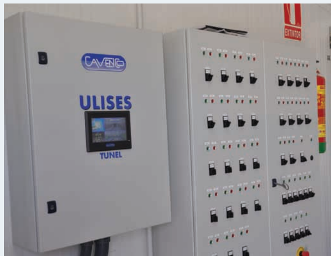
Panel de control y equipo Ulises.
