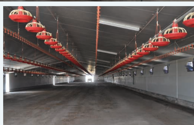
Nave cerrada con ventilación túnel de dos años de antigüedad.
