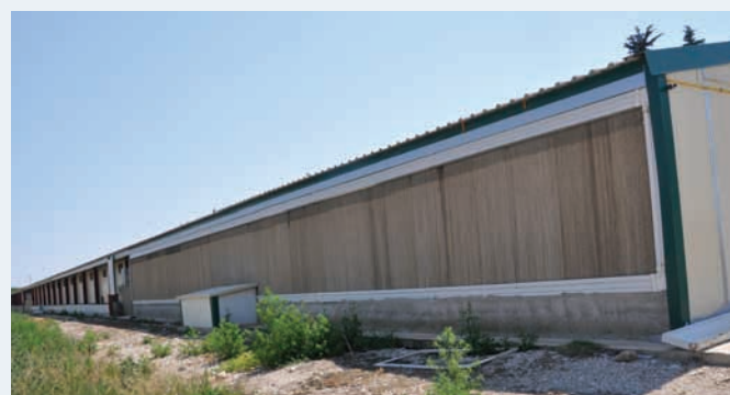
Detalle de los paneles refrigeradores de celulosa de la nave con ventilación tipo túnel.
