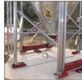
Silos con células de carga
