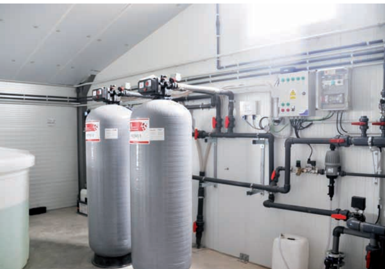
▲ Sala para los equipos de tratamiento de agua.
