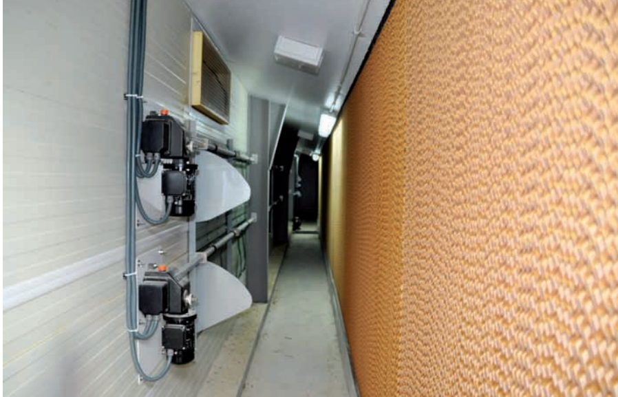
▲ Interior del túnel de refrigeración, con los paneles de celulosa y la doble trampilla mecanizada para la entrada del aire frío en la nave.
