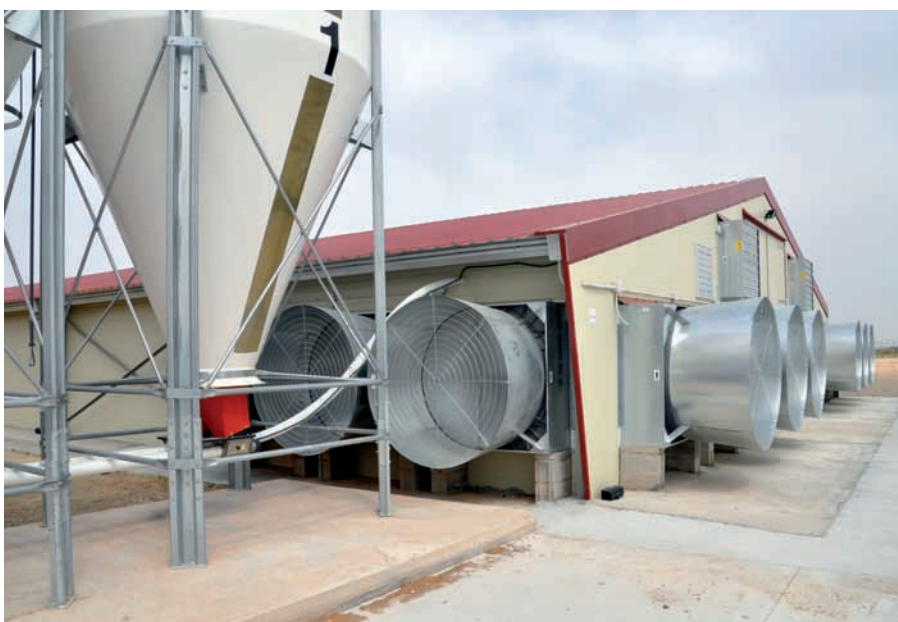
▲ Los ventiladores de gran caudal, en el extremo final de una nave.
