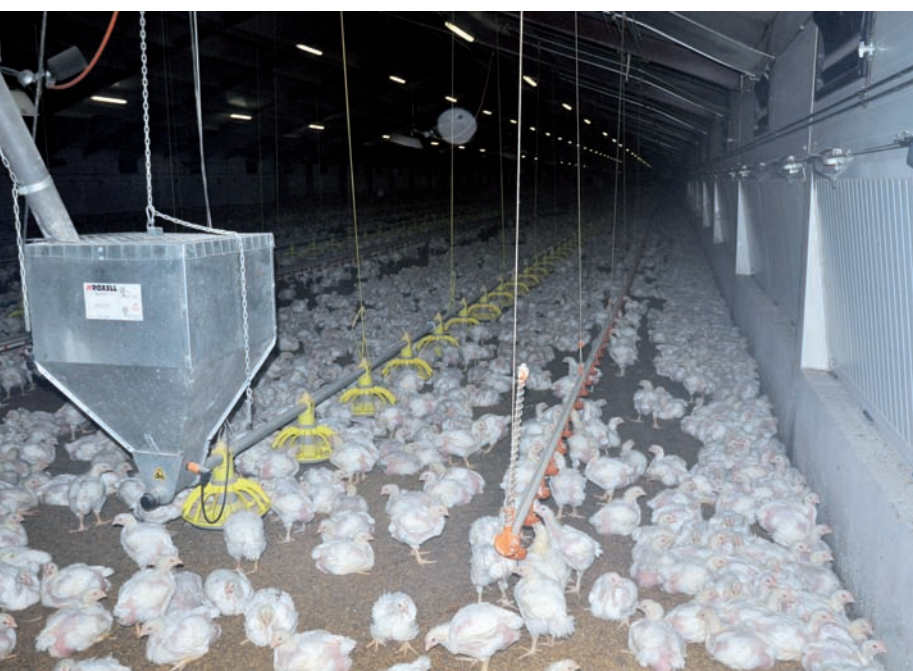
▲ Otra nave de pollos, caldeada igualmente por biomasa y suelo térmico.
