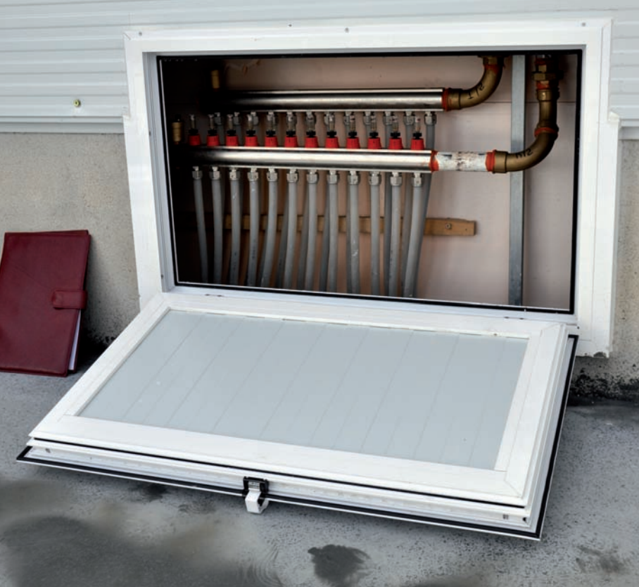
▲ Una de las trampillas de acceso a los tubos de agua para el suelo térmico.
