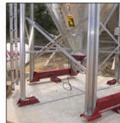
Silos con células de carga
