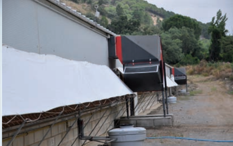
Lateral de la nave en el que pueden verse los intercambiadores de calor, los depósitos en suelo y el toldillo de lona para proteger los "coolings".
