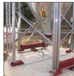
Silos con células de carga
