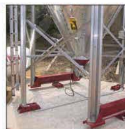
Silos con células de carga
