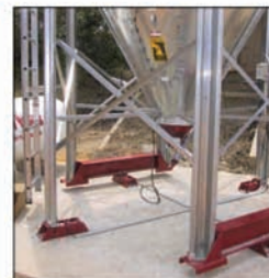
Silos con células de carga
