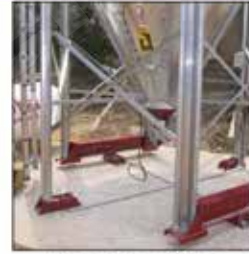
Silos con células de carga
