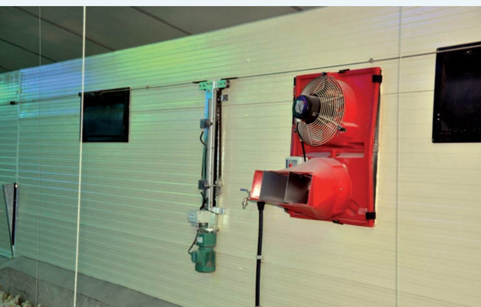
Interior de uno de los 6 intercambiadores de calor en funcionamiento en la nave.
