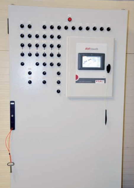
El cuadro eléctrico, con el panel del ordenador para control ambiental.
