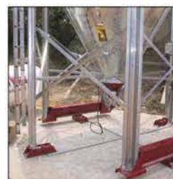
Silos con células de carga
