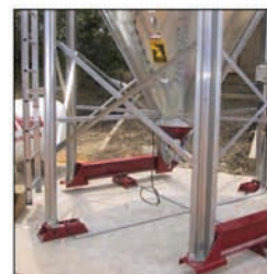
Silos con células de carga
