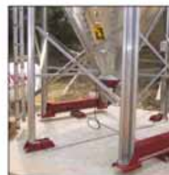
Silos con células de carga
