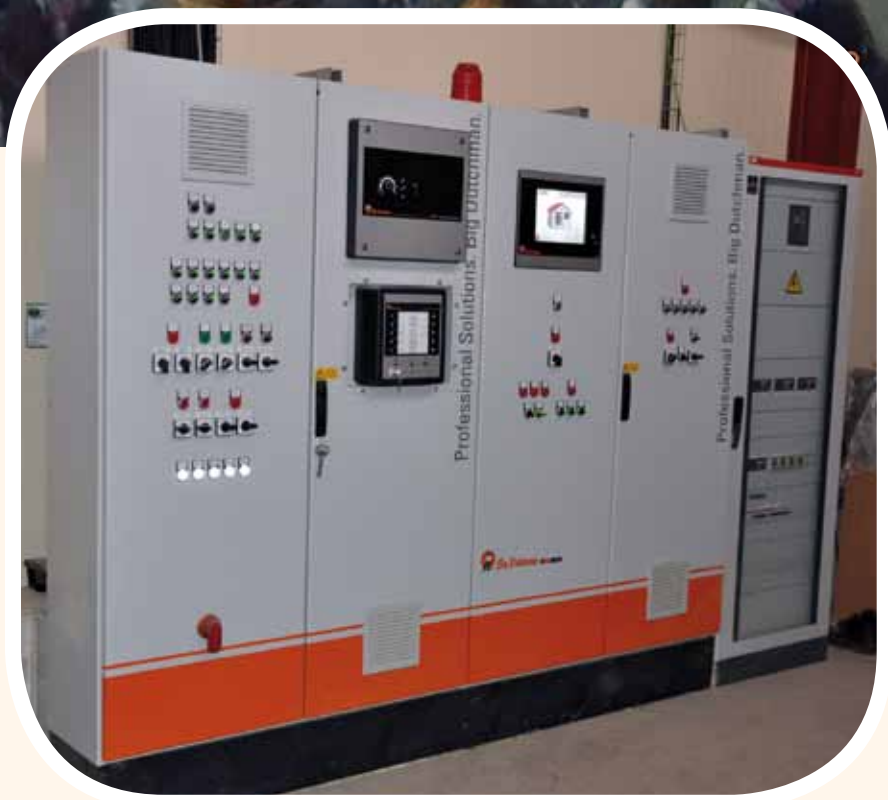
El armario con el ordenador y los equipos de control de la nave.
