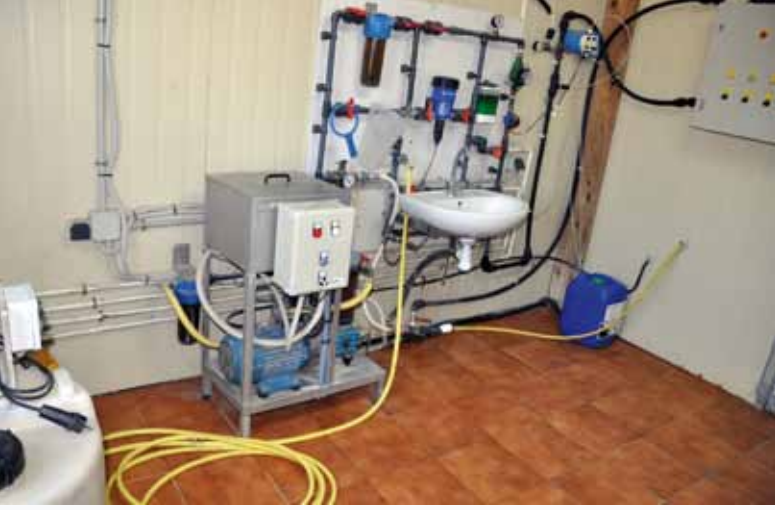
Un detalle del cuarto técnico, con la bomba para activar el circuito de refrigeración, un filtro de agua, un dosificador para medicaciones, lavabo, etc.
