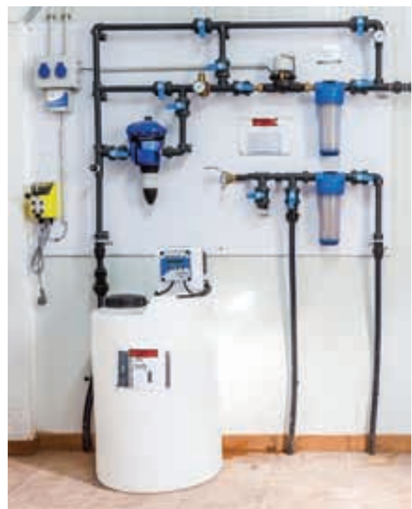
Fig. 3. Ejemplo de instalación más completa.
