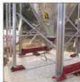
Silos con células de carga
