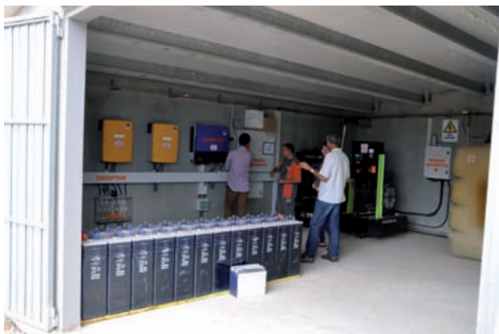
El equipo eléctrico de la granja anterior, con los moduladores, el convertidor, el grupo electrógeno y las baterías.
