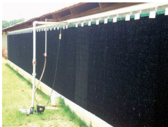
Sistema evaporativo enfriador con paneles de plástico.
