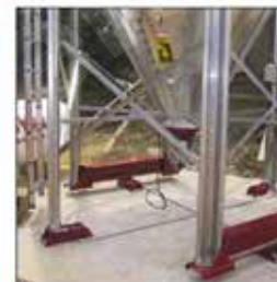
Silos con células de carga
