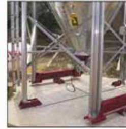
Silos con células de carga
