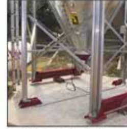
Silos con células de carga
