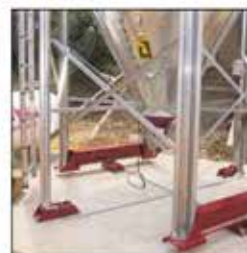
Silos con células de carga
