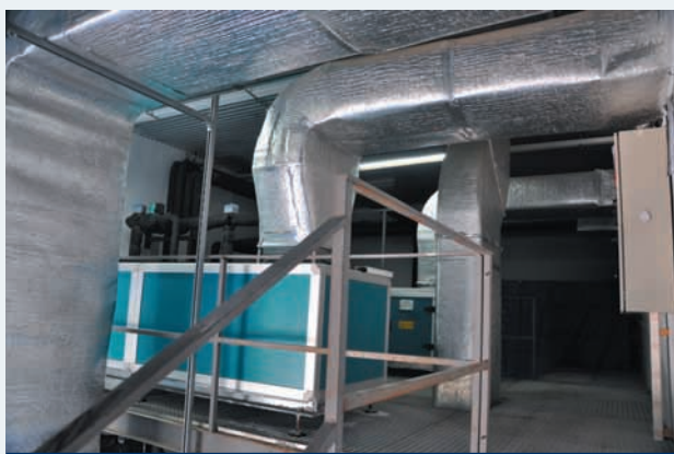
Aspecto parcial de la sala de climatización ambiental.
