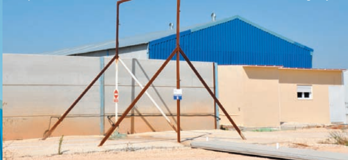
Dispositivo de rociado automático de vehículos a la entrada de la granja.
