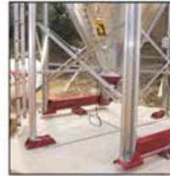
Silos con células de carga
