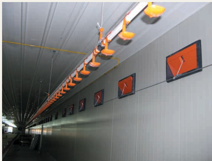
Una de las hileras de bebederos de tetina, con recuperador. Véanse también las trampillas de entrada de aire.
