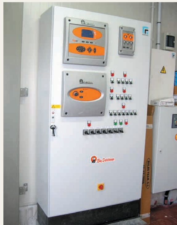
El compacto cuadro de mandos con el ordenador "Viper", para control del medio ambiente de la nave.
