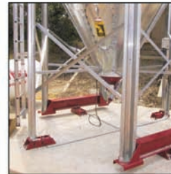
Silos con células de carga
