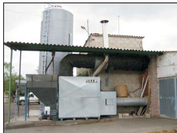
Granja avícola con calefacción de aire por biomasa.
