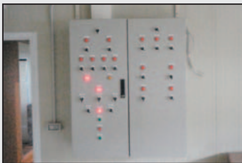
Detalle del cuadro de control del sistema eléctrico. Foto: Esteban Atxa Calvo
