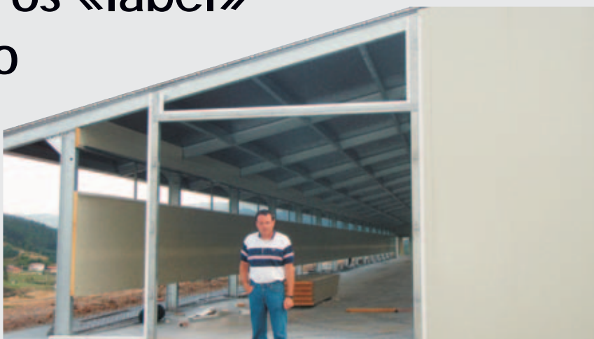
En la fotografía, Koldo Bilbao Agirre, promotor de la granja, cuando aún se estaba construyendo. Foto: Esteban Atxa Calvo
