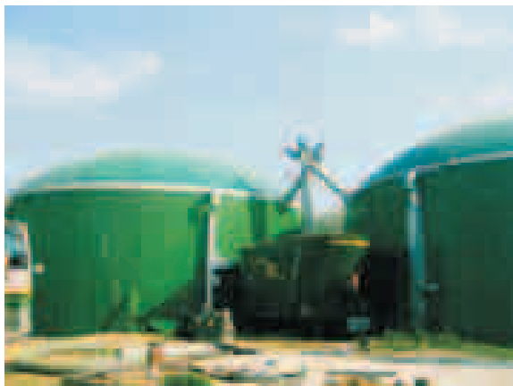
Instalación de metanización en fase líquida
