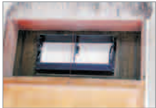
Fig. 5. Detalle de una entrada de aire SKOV-Agrener en la que se aprovecha la antigua ventana de guillotina para periodos de emergencia (en ausencia de luz el controlador climático abre las ventanas de guillotina)
