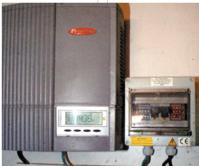
La corriente eléctrica creada por los paneles llega hasta el ondulador —instalado en el almacén— que transforma la corriente continua en corriente alterna.
