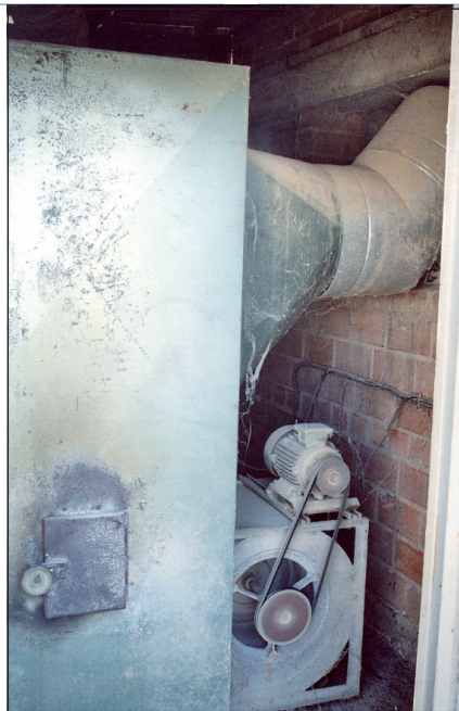
La caldera de biomasa, con la puerta para retirar las cenizas y el tubo de inyección de aire caliente en la nave
