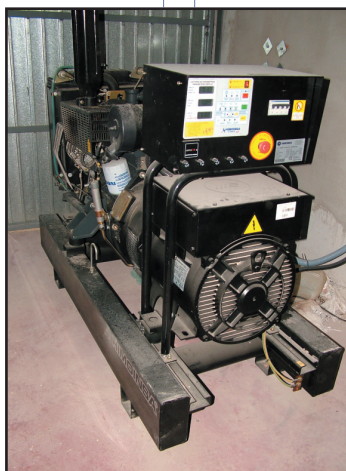
Uno de los grupos electrógenos para cuando falla el suministro eléctrico.
