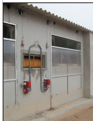
Vista exterior de las automatizaciones de las ventanas.
