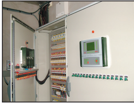
La complejidad del cuadro eléctrico es proporcional a las dimensiones de la granja.
