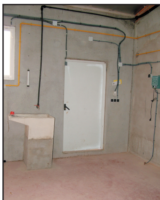
Un lavadero a la entrada del almacén facilita la higiene.
