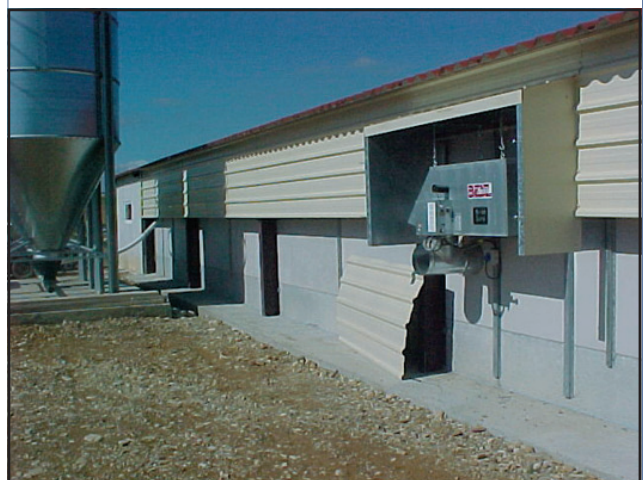
Un calefactor aerotermo a gas, instalado en el exterior de un criadero (Foto gentileza de Serupa Ibérica, S.A.)
