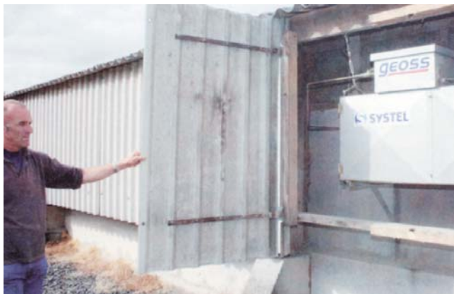
Desde la transformación del edificio en tipo Colorado y la instalación de generadores de aire caliente Géoss, de potencia progresiva y con reciclaje del aire, el consumo de gas ha descendido en un 15 %.
