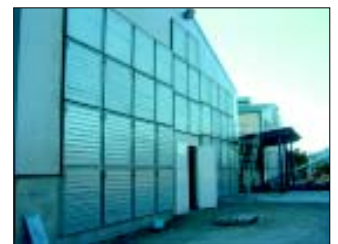
Batería de ventiladores de GANAL en el piñón de una nave.
