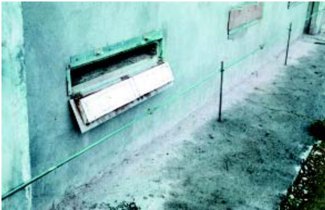
Detalle de una trampilla para la entrada de aire, aislada, y de la tubería con una boquilla nebulizadora situada frente a cada una de aquéllas.
