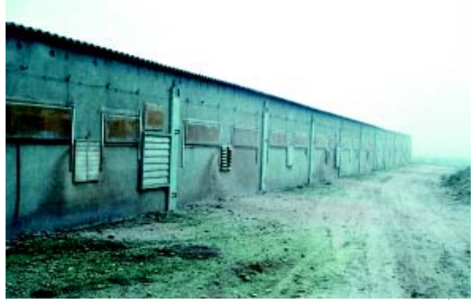
Vista parcial del exterior de la fachada con algunos extractores en funcionamiento.
