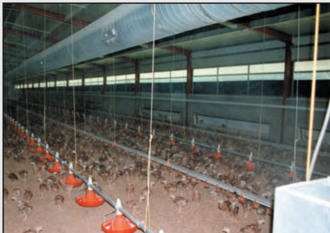
Detalle de la canalización para distribución del aire caliente generado por una estufa de biomasa.
